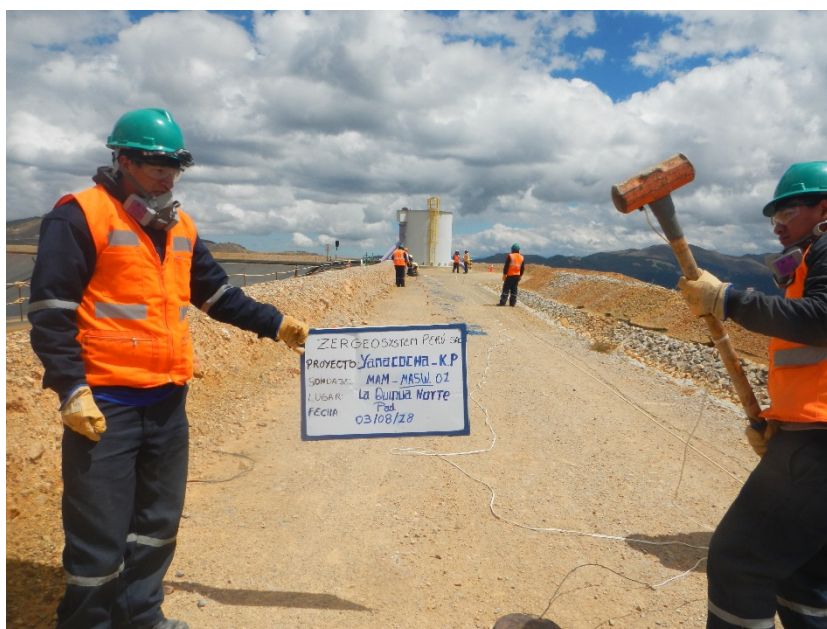
Fotografía 02: Vista panorámica de la zona de trabajo donde se realizó el ensayo sísmico MASW-01. Se observa el tendido del cable trigger, geófonos un plato de metal y el accionar de la comba propia del ensayo.
