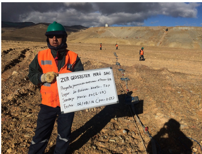
Fotografía 17: Vista panorámica de la zona de trabajo donde se realizó el ensayo sísmico MASW-2D. Se aprecia una faja unida al cable de refracción sísmica y los geófonos. En la fotografía se muestra las posiciones del 11 - 14 del presente ensayo.
