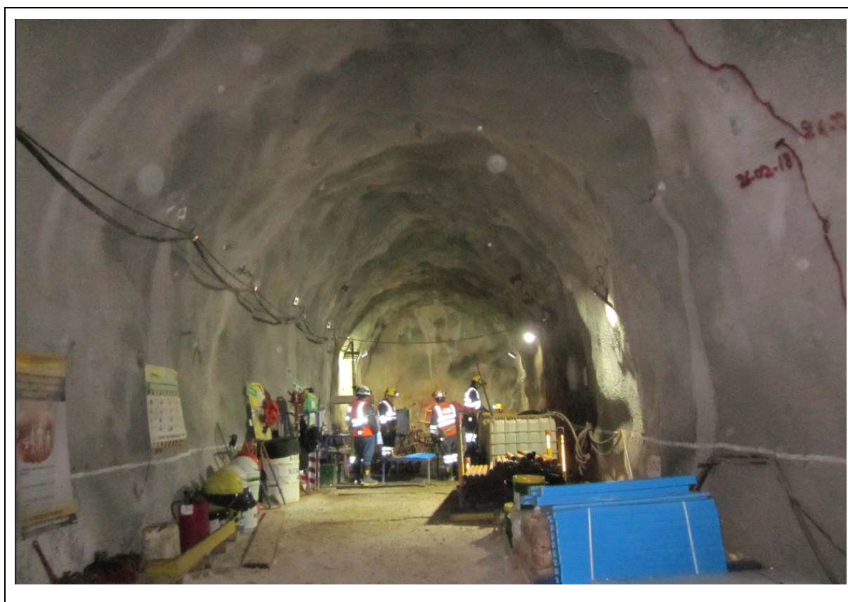
Figura 10, Roca tipo IV-B es Sostenido en el Túnel 3800 drift. Señales de Menor Agrietamiento (Trazas de Color Rojo Identifican las Grietas)
