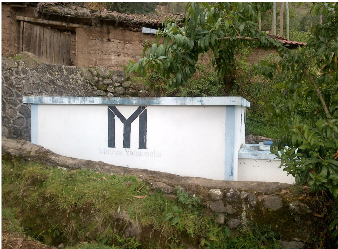
Captación SAP del caserío de Manzanos Capellanía
