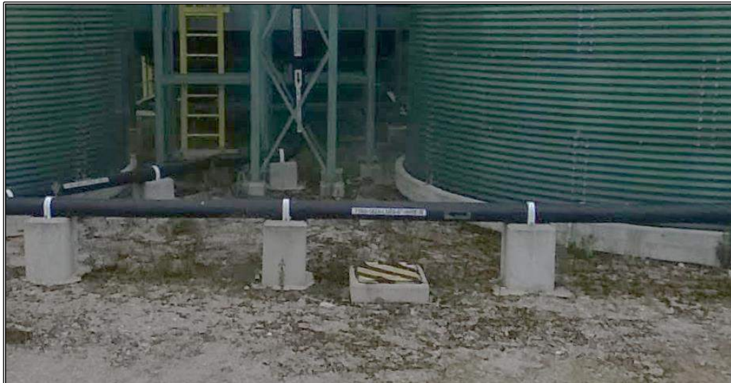
Figura 41: Tuberías HDPE a Nivel de Piso
