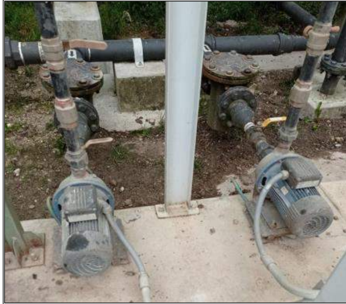
Figura 40: Bombas a Nivel de Piso
